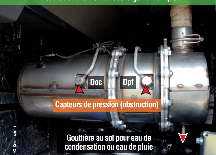
Module de traitement au déchargement unique
